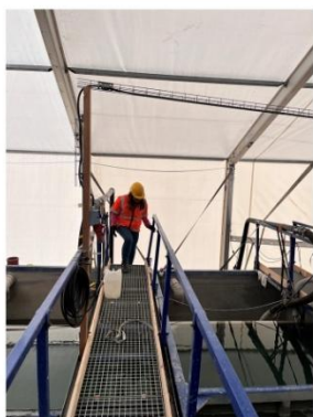
Gångbro ovanför vattenreningscontainrar
